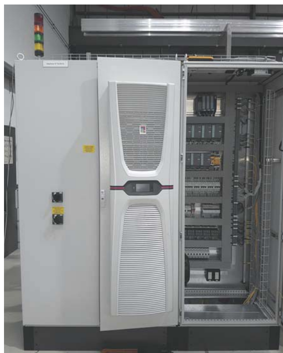
Armoire de l'appareillage, fournie par ALPS Automation SA.
