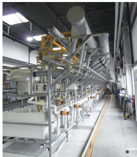
Partie inférieure de l'installation avec systèmes de pompe.
