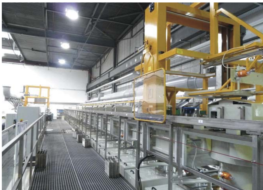
Vue de l'installation.
